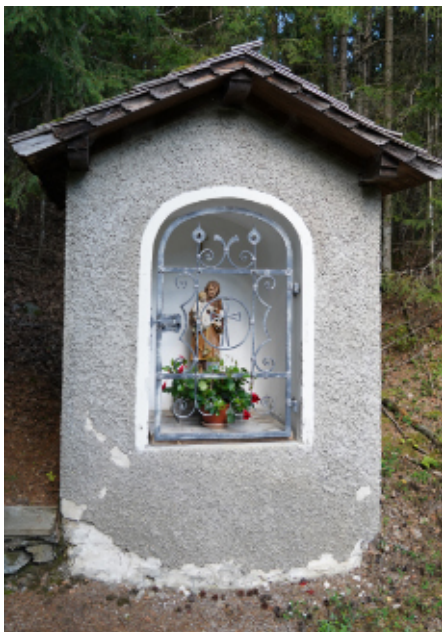
Das Joseph-Stöckl in Göriach befindet sich zur Zeit in keinem guten Zustand.
